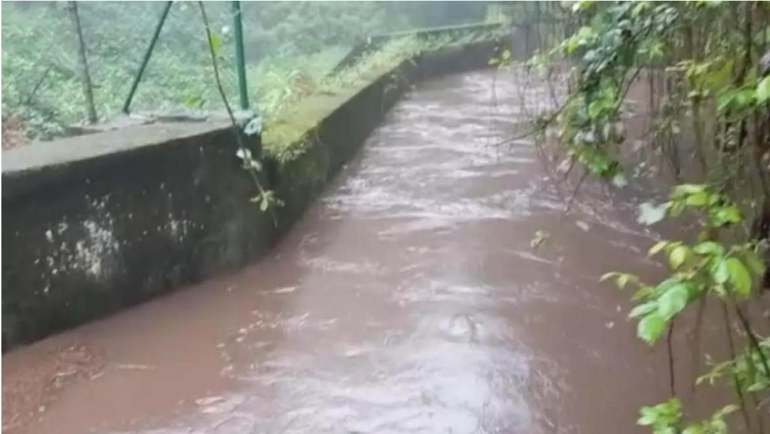
Imagen de archivo de un tomadero de la zona de Los Tilos llevando agua de la lluvia a La Laguna de Barlovento. DAVID ROCHA
